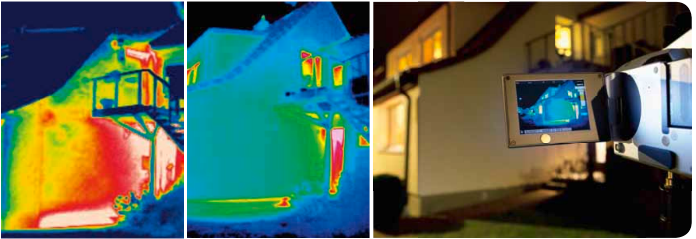
Hier ist der Erfolg deutlich zu sehen: Links in Rot und Weiß die Wärmeverluste vor, in der Mitte nach der Dämmung der Außenwand. Festgestellt werden solche Wärmelecks durch Thermografieaufnahmen in der kalten Jahreszeit (rechts).
