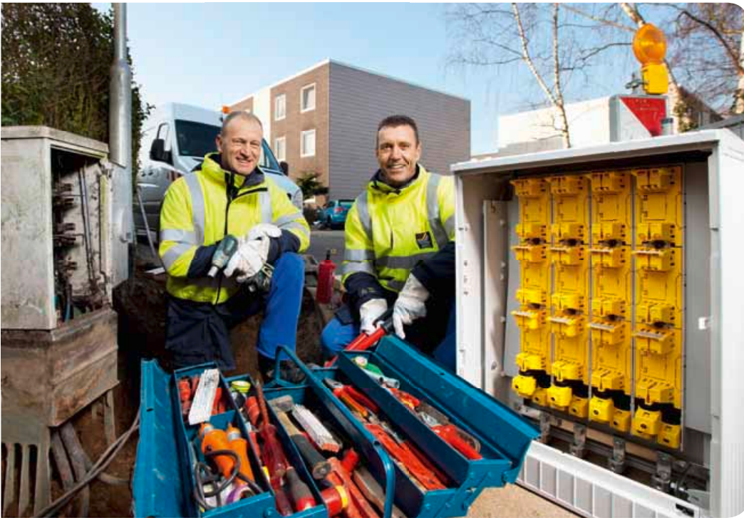
Sie kümmern sich darum, dass in Sachen Strom alles fließt: Wendelin Sagstetter (links) und Werner Held von der Stadtwerke Duisburg Netzgesellschaft.
